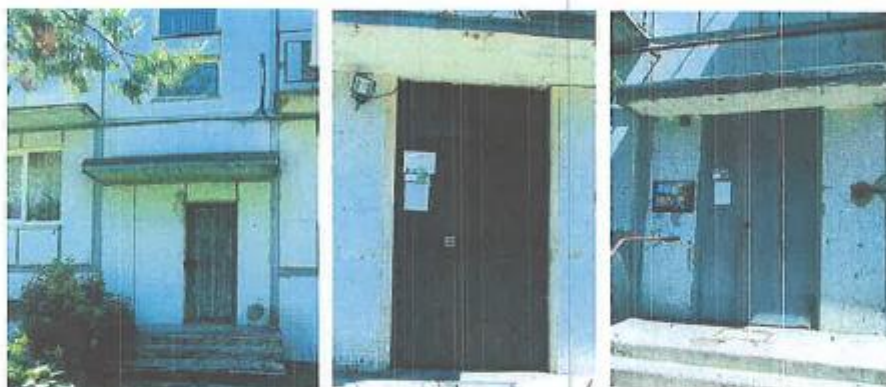
5 pav. Prie pastato augantys krūmai ardo pamatus, gadina fasadą. Bendro naudojimo patalpų išorinės durys nusidėvėjusios, senos, kai kurios paveiktos korozijos.
