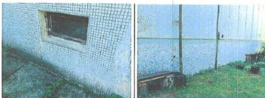
3 pav. Netvarkingos nuogrindos, vietomis nėra. Nusidėvėjęs pastato fasadas - nesandarios sieninių plokščių tarplokštinės siūlės, sieninių plokščių paviršius pažeistas, vietomis suaižėjęs.
