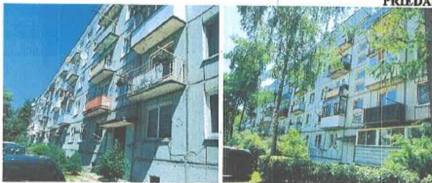
1 pav. Gyvenamosios paskirties daugiabutis namas. Nusidėvėjęs pastato fasadas - nesandarios sieninių plokščių tarplokštinės siūlės, sieninių plokščių paviršius pažeistas, vietomis suaižėjęs.
